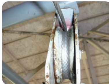
吊下げバスケットゴール直上車の摩耗
